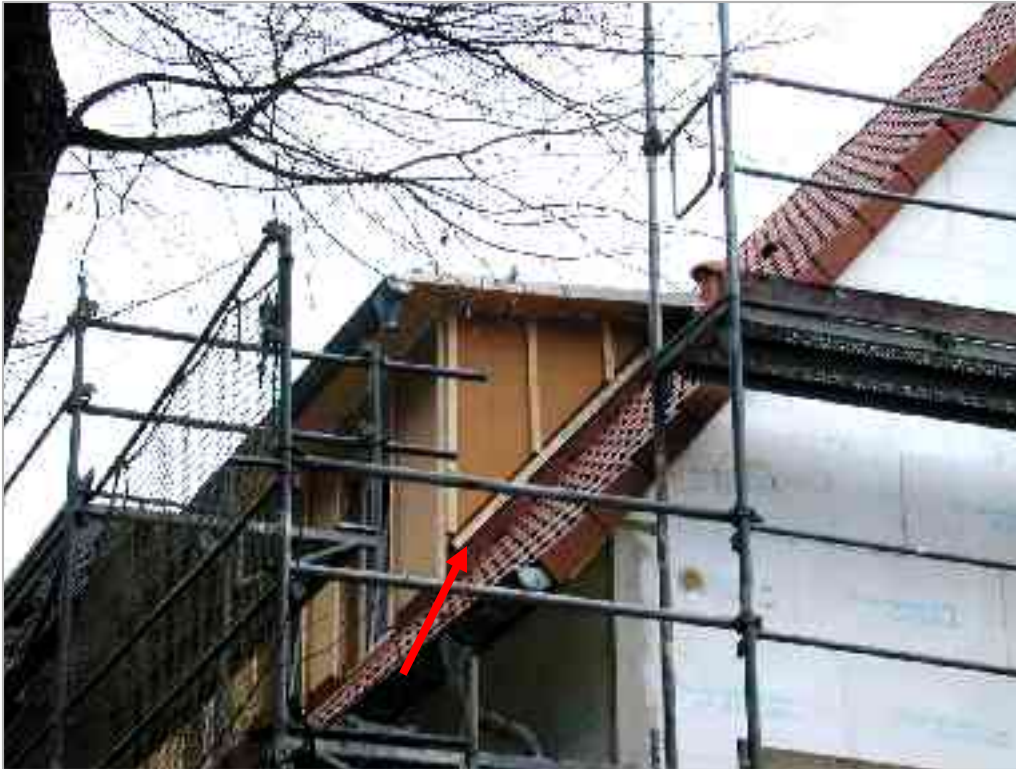
Dachlatte verhindert Hinterlüftung
